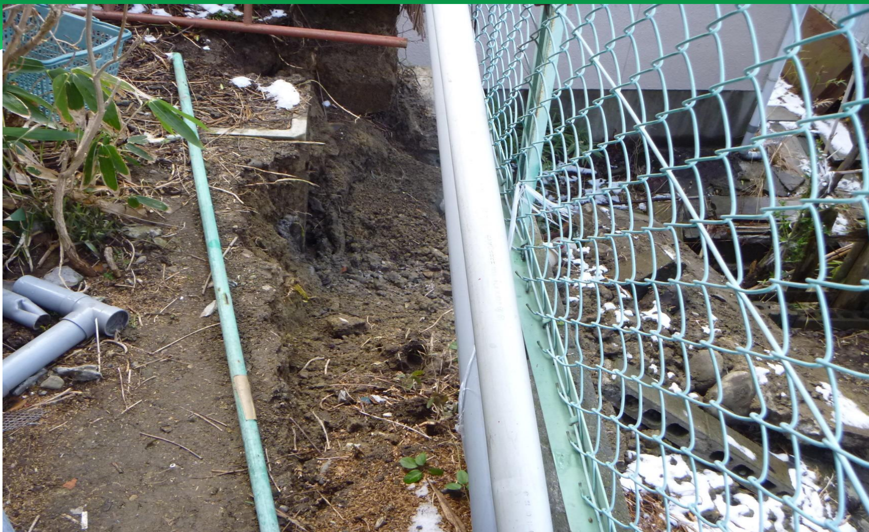
21. 2011. 3. 15 応急危険度判定 仙台市青葉区旭ヶ丘住宅地盤崩壊
