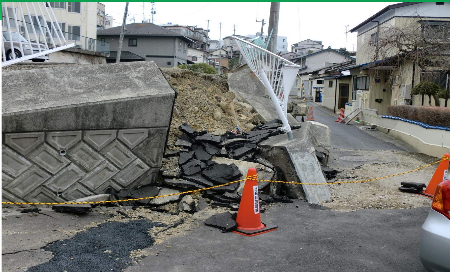
15. 2011. 3. 15 地盤の崩壊 仙台市旭が丘団地
