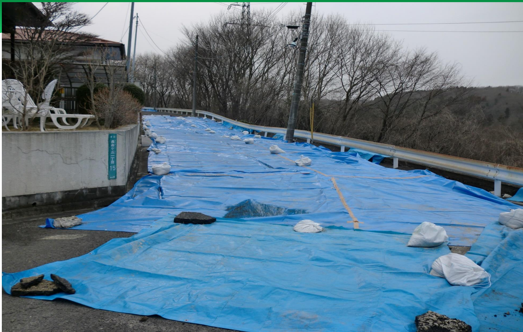
17. 2011. 3. 14 仙台市泉区団地 住宅周りのがけ地に面した道路陥没
